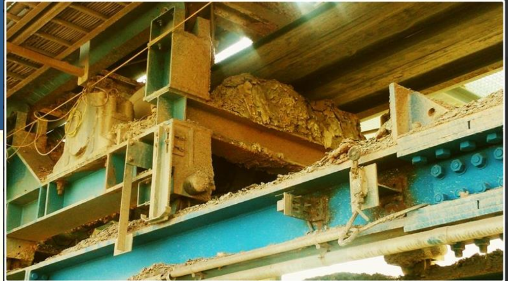
COD.CV0025/ASEO Se observa acumulación de material sobre en sector polea tensora.
