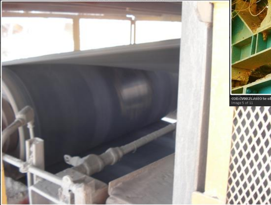
COD.CV0006/POLÉAS-PS Se observa masto metálico a la vista en zona centro de la polea.
