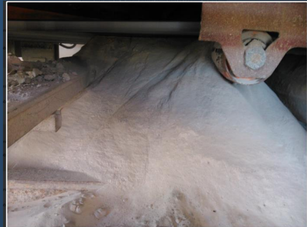
COD.M002/ROLLOS 2800 Se observa acumulación de material fino en polea de aspecto.
